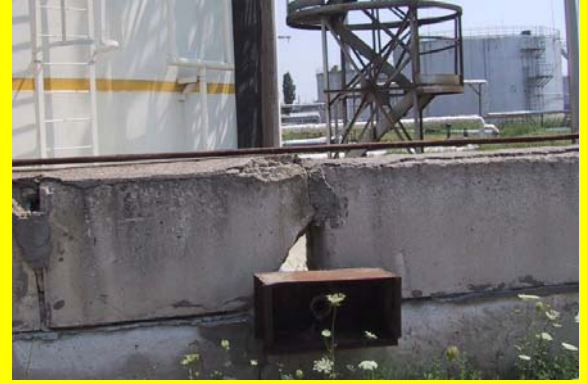
Haziran – Tank çiftliği dökülme toplama havuzu duvarında bir delik
