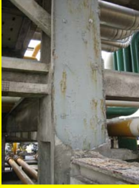
Mayıs – Çelik boru köprüsü ayağındaki hasar görmüş yangınadayanır kaplama
