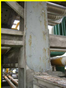
Maj – skadat brandskydd på en pelare i en rörgata
