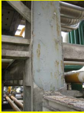
Mai – ødelagt brannbeskyttelse på en støttepilar til en rørgate
