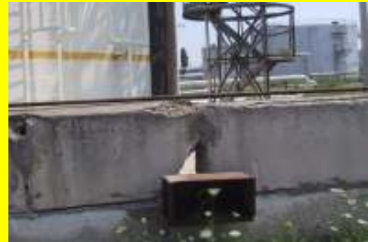
Junio – un hoyo en el muro de un dique de contención en una zona de tanques
