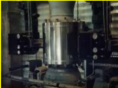
Abril – Cubierta aislante en una válvula sin bridas de pernos largos
