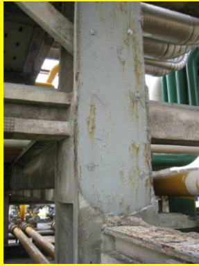
Mei – Beskadigde brand-beskerming van 'n pyrrakkolom
